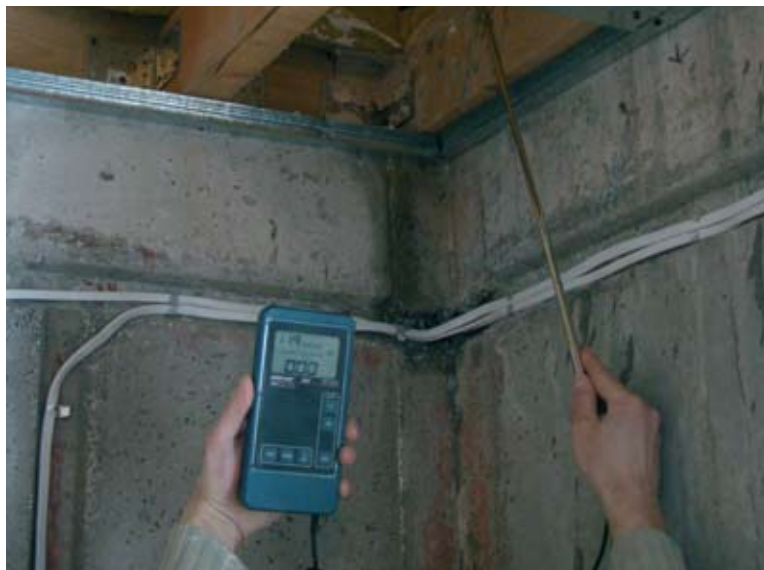
Fot. 6. Poszukiwanie za pomocą anemometru nieszczelności na łączeniu paroizolacji ze ścianą. Przyrząd wykazuje zerowy przepływ powietrza
